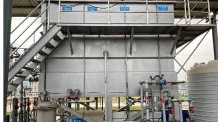
中山中嘉污水厂AOA中试
