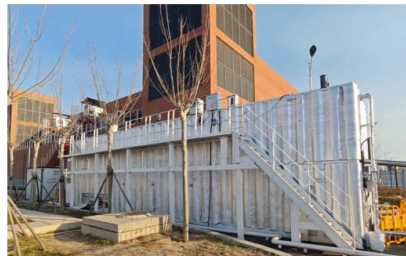
郑州新区污水厂AOA中试
