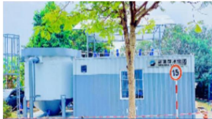
深圳滨河水质净化厂AOA中试
