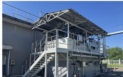
惠州金山污水厂AOA中试
