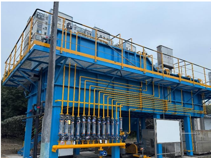
合肥王小郢污水厂中试
