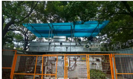
宁波岚山污水厂AOA中试
